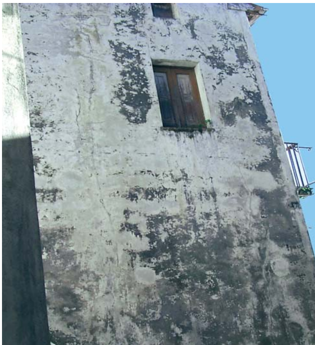
Figura 4.2 Lesioni verticali alla fascia fra le due aperture (tipo1) e lungo la connessione al muro trasversale a sinistra (tipo 6). Livello del danno: D1 (Tortora, CS, 1998)
