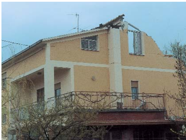
Figura 4.25 Crollo parziale di una copertura in travi di cemento armato e tavelloni senza caldana. Livello del danno alla copertura: D4-D5
