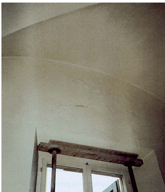
Figura 4.3 Lesione in corrispondenza all'architrave verticale (tipo1) e diagonale (tipo2); puntellamento cautelativo. Livello del danno: D1 (Correggio, RE, 1996)
