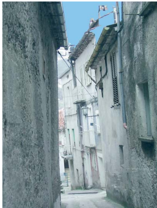
Figura 4.5 Fuori piombo preesistenti in un antico centro storico. Livello del danno preesistente per l'edificio: D1
